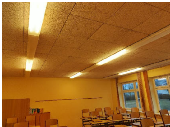
Deckenbeleuchtung u. Leuchtstofflampen
