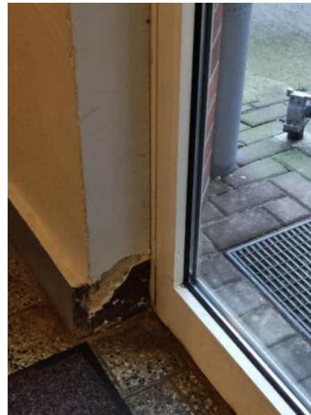
Sockelschaden Flur – Außentür
